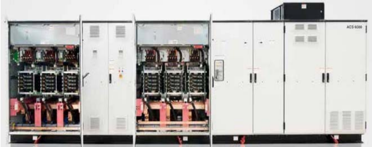
Şekil-28 OG VFD ünite [28]
